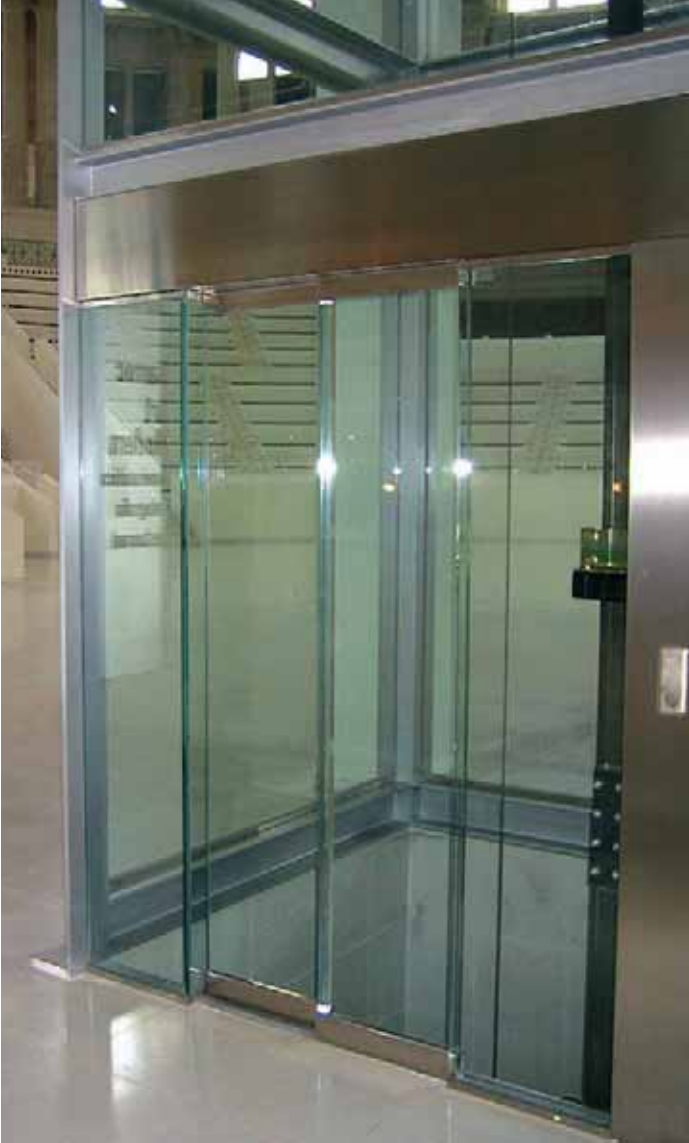
Puerta cristal total_Museo de arte moderno de Catalunya. Complete glass door_Museum of Catalunya.
